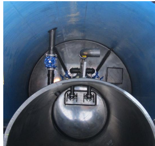
Bild 2 : Sicht von oben in einen Schacht Image 2 : Vue en plan d' un puits sec avec station de relevage
